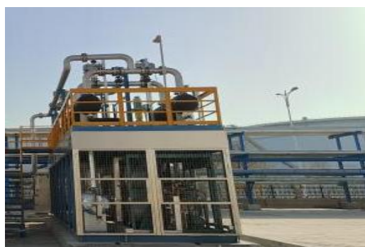
原料产品罐区油气回收（二级冷凝）
