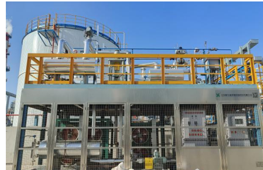
装置区配套中间罐区油气回收（二级冷凝）
