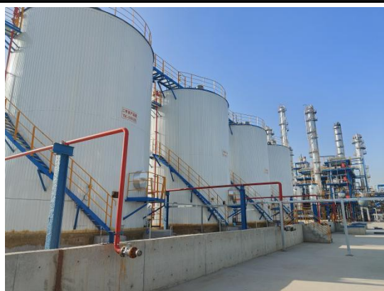
中间罐区（从右向左依次为新鲜溶剂罐、湿溶剂罐、二甲苯罐）
