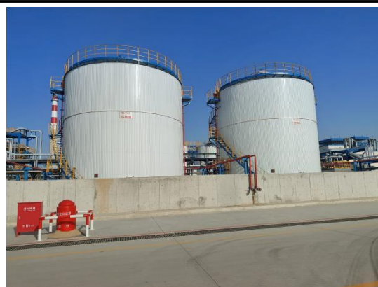
中间罐区（开工循环罐、不合格产品罐）
