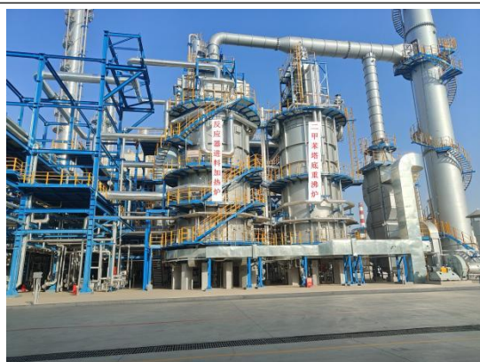
二甲苯塔重沸器加热炉、反应器进料加热炉 烟气
