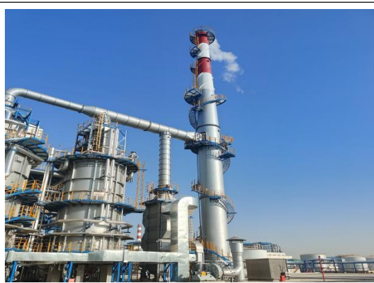
加热炉排气筒 DA162（高 60m，直径 1.52m）
